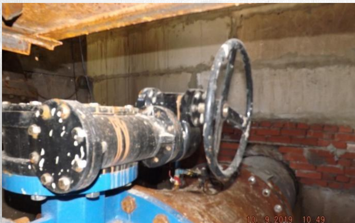
Принятый заказчиком фланцевый затвор KVANT (до проведения проверки)
